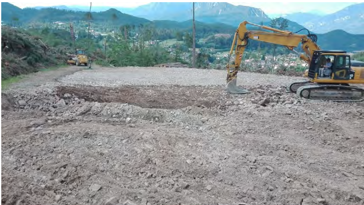
Fig.11.10 Adeguamento piazzale locale "La Cros" nel Comune di Baselga di Pinè (fonte: UDF Pergine V.).
